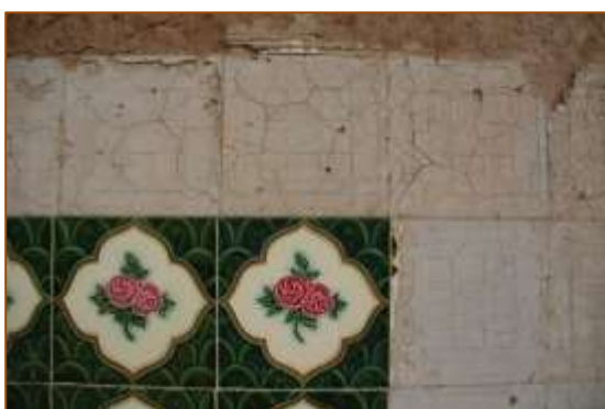
〈図6 ピーラーマル・チャトゥルブジ・マカリア邸壁面のタイル剥落痕 (ラージャスターン州バガル、1928年造営)〉
